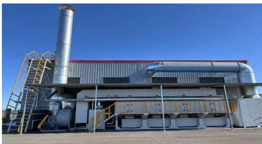
废气处理装置
